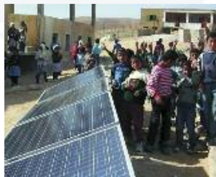
Des écoliers du village arabe de Rahayda, à l'est de la ville de Bethléem. Les panneaux solaires fournissent l'électricité nécessaire pour éclairer l'école.
